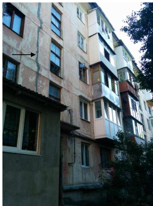
Рис. 3. Фрагмент фасада 5-ти этажного жилого дома. Фиксируется развитие вертикальной сквозной трещины как следствие неравномерной осадки
