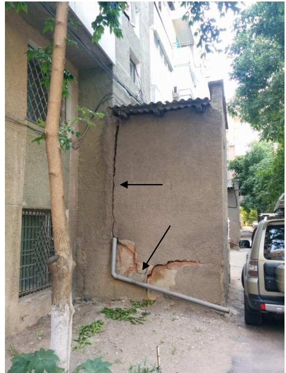
Рис. 5. Фрагмент фасада многоквартирного жилого дома. Неравномерная осадка конструкций подвезда
