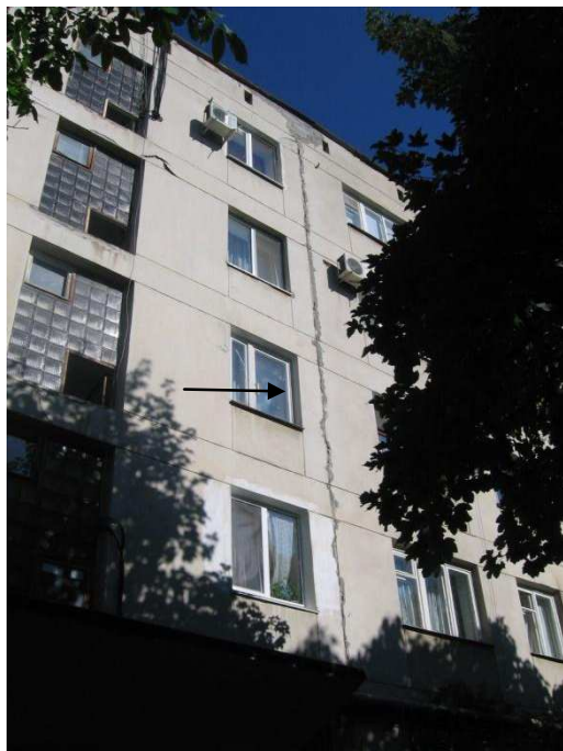
Рис. 2. Фрагмент фасада многоквартирного жилого дома. Видна сквозная трещина между стеновыми панелями
