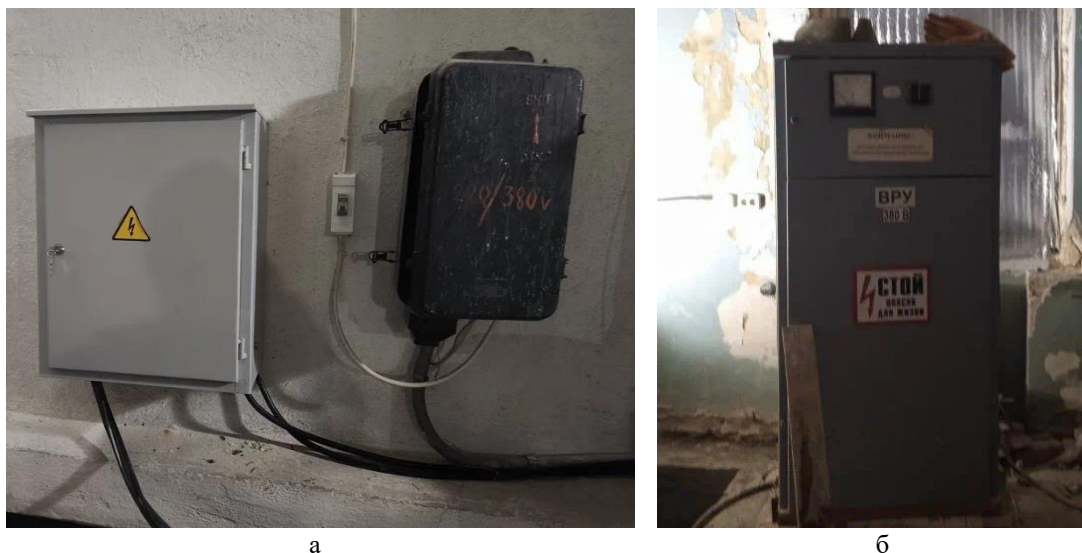
Рис.1. Щитовое оборудования в здании панорамы «Оборона Севастополя в 1854-1855 годах» до проведения реставрационных работ: а). – в помещении подпредметного плана; б). – вводный щит в помещении электрощитовой
